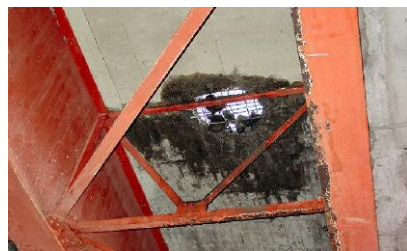
写真-1 床版の損傷事例（コンクリート床版の抜け落ち） 2
