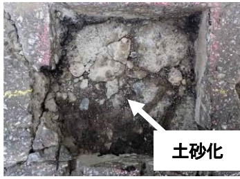
写真-8 N橋の舗装はつり調査による床版上面の劣化状況確認
