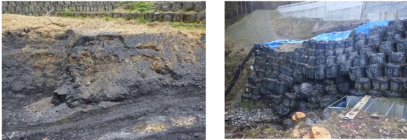
図-5 現場の変状の様子
