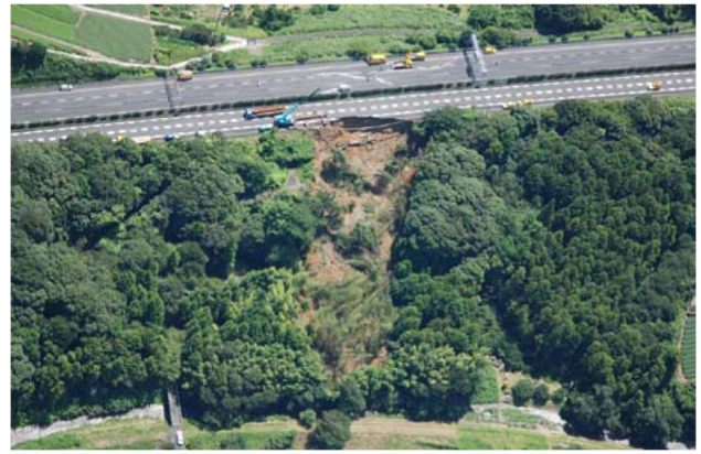
図-6 東名高速道路 盛土のり面崩壊
