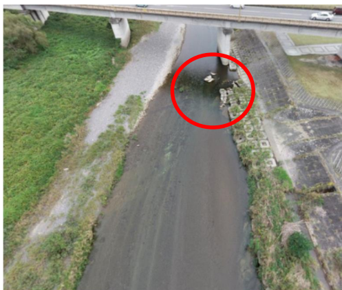
図-6 護床ブロック(2tサイズ)の欠損
