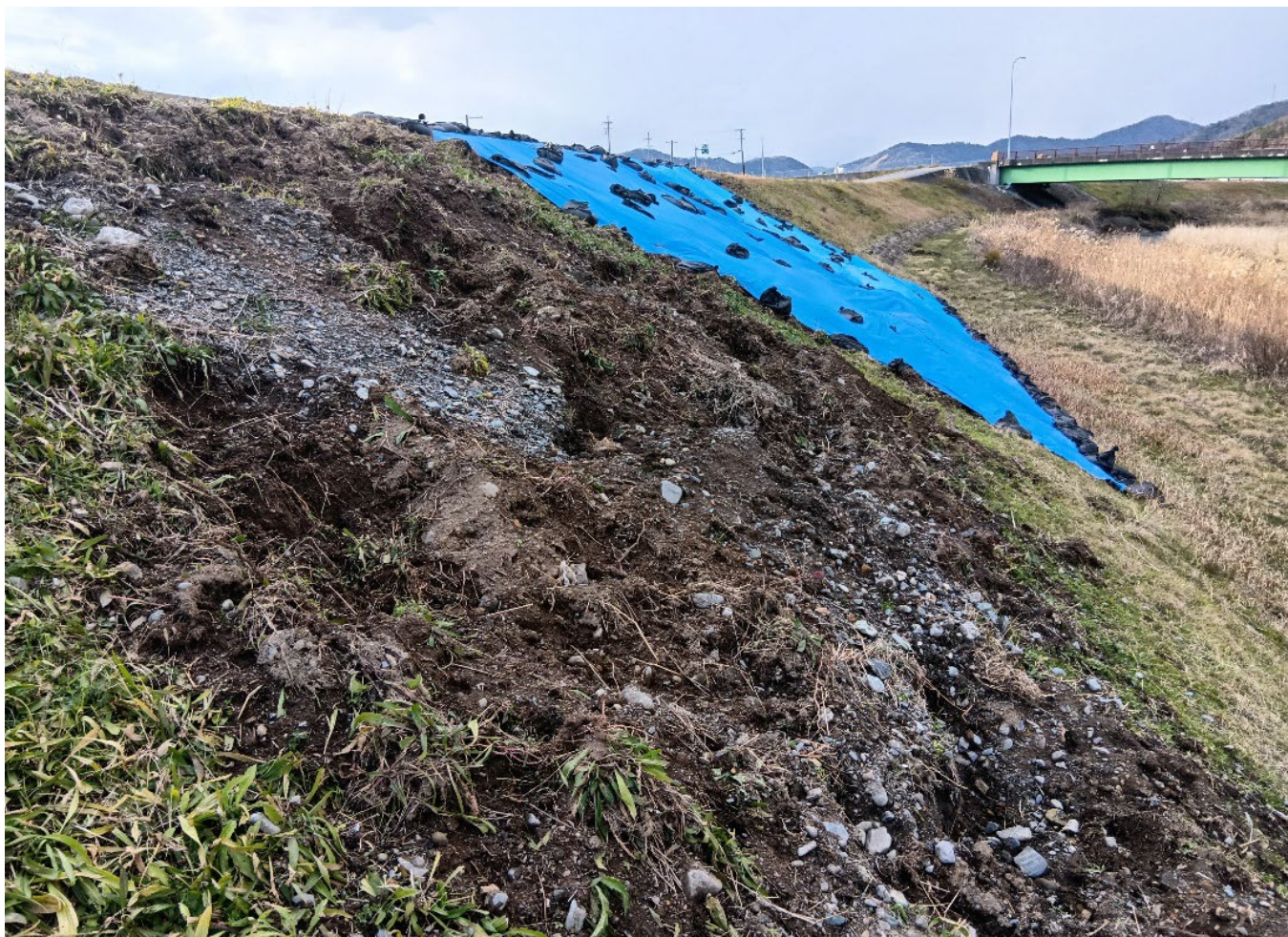
河川堤防法面のイノシシによる掘り起こし被害状況
