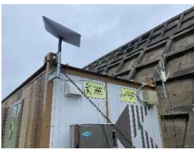
衛星アンテナ設置状況
