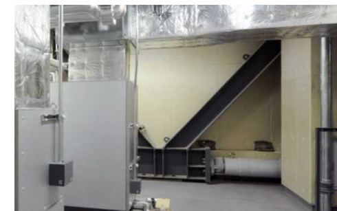
地震への特別な対策 (制振装置)
