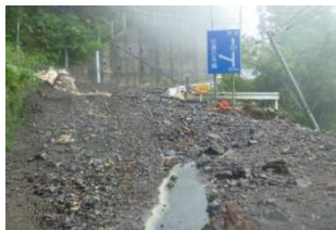
写真① 国道168号崩落状況(撮影時期:H23.9)
