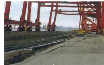
阪神・淡路大震災で被災した神戸港六甲アイランドRC3
