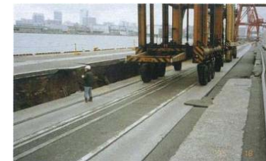
阪神・淡路大震災で被災した神戸港ポートアイランドPC7-9
