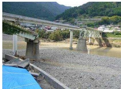
写真① 折立橋落橋後 (撮影時期: H23年紀伊半島大水害直後)
