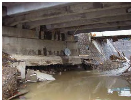
桑間橋の被災状況 (写真①)
