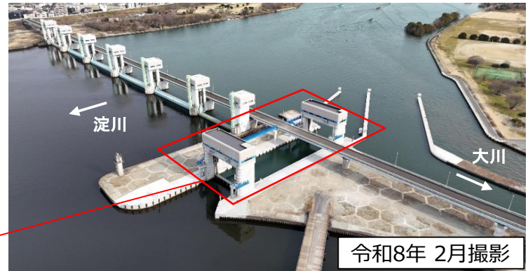
漏水の状況写真
