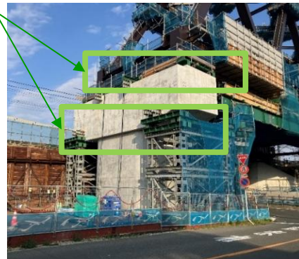
写真1 ベント転倒防止設備（P46橋脚）
