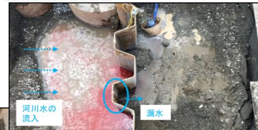
写真1 矢板の継ぎ目からの漏水
