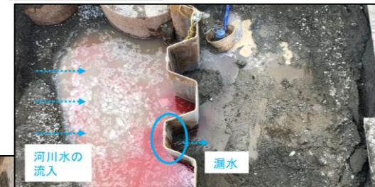
写真1 矢板の継ぎ目からの漏水
