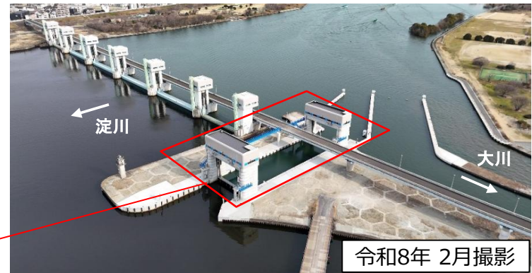
漏水の状況写真
