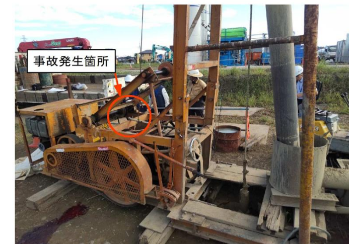
図 事故発生箇所
