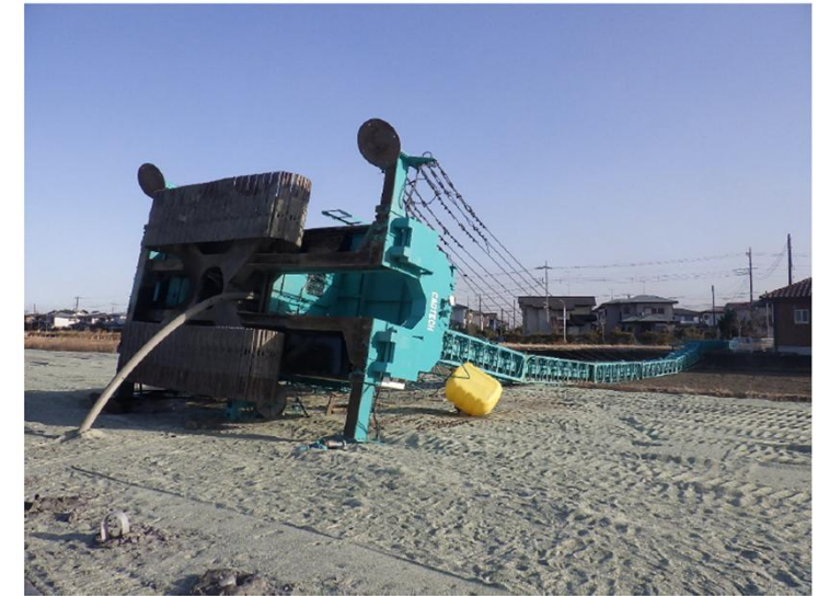
図 事故状況写真
