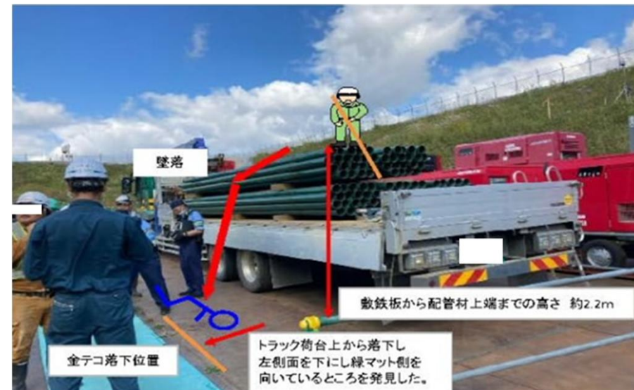
図 事故状況写真
