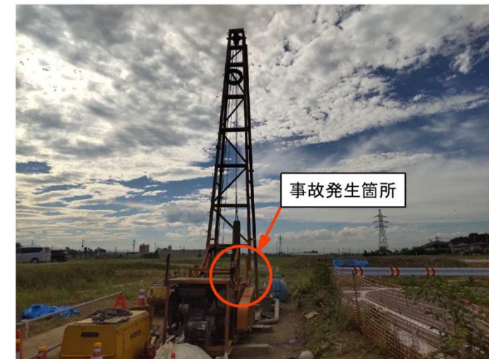
図 事故状況写真
