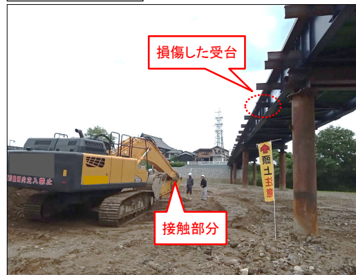
事故状況写真
