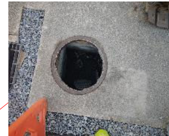
雨水排水桝: 400φ鉄蓋破損
