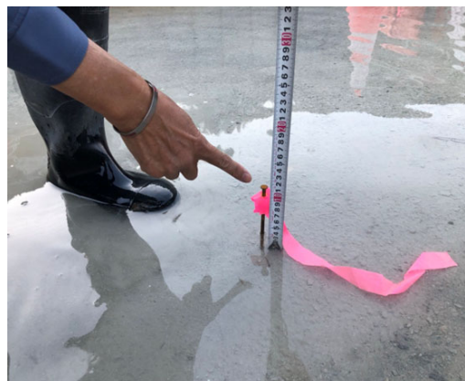
コンクリート面から10cm程度飛出していた
