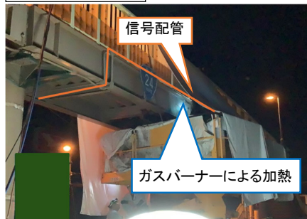
事故状況写真①
