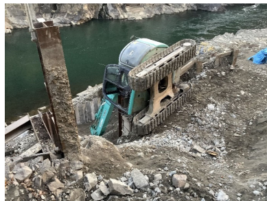
事故状況写真①
