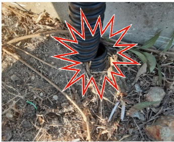
事故状況写真① 切断箇所
