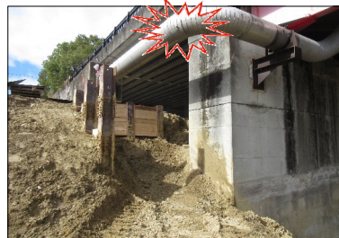
事故状況写真① 損傷箇所
