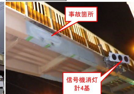
事故状況写真③
