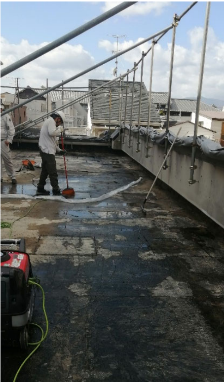
事故状況写真 (既設防水層撤去箇所)
