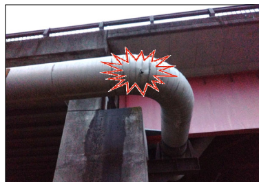
事故状況写真② 損傷箇所
