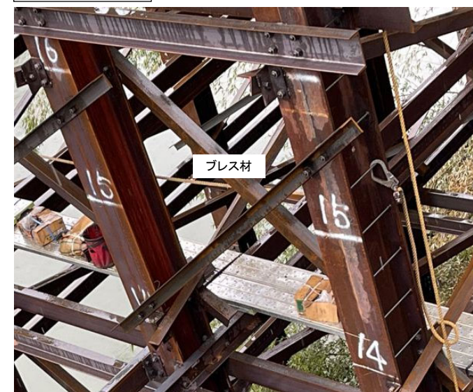
事故状況写真②
