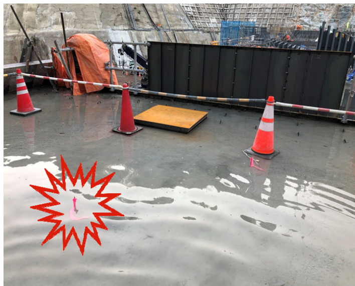
測量用の釘(ボーリング位置明示)につまづき転倒し、右膝を強打した
