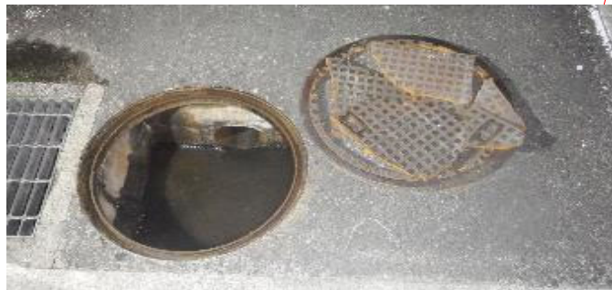
雨水排水桝: 450φ鉄蓋破損
