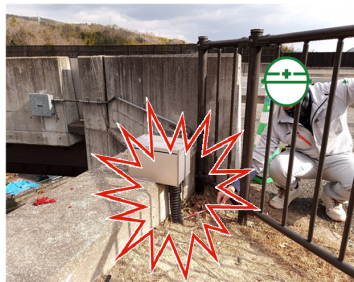
事故状況写真② 切断箇所
