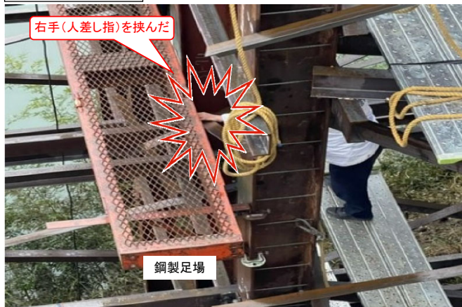
事故状況写真①
