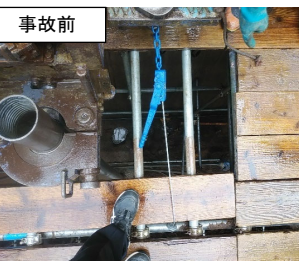
開口部の塞ぎ養生無し
