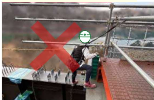
立入禁止措置を超えて桁上へ移動
