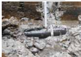
上水管破損 φ1cm程度 側溝 底打 かぶり 2cm
