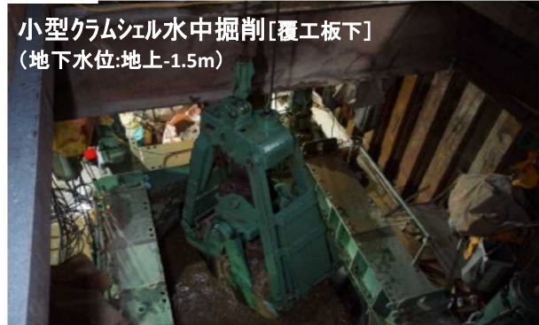
小型クラムシェル水中掘削[覆工板下] (地下水位:地上-1.5m)
