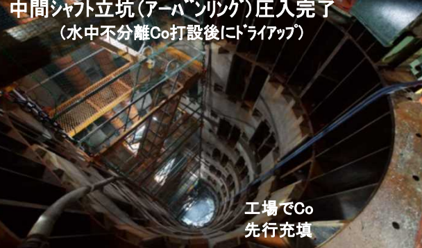
中間シャフト立坑(アーバンリング)圧入完了 (水中不分離Co打設後にドライアップ) 工場でCo先行充填
