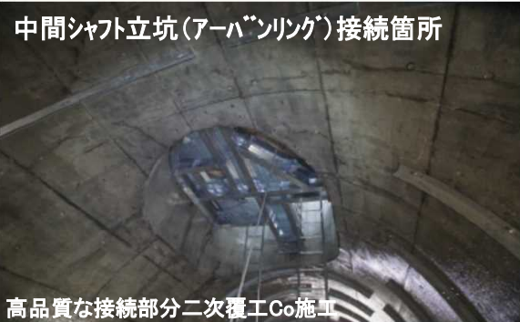
中間シャフト立坑(アーバンリング)接続箇所 高品質な接続部分二次覆工Co施工
