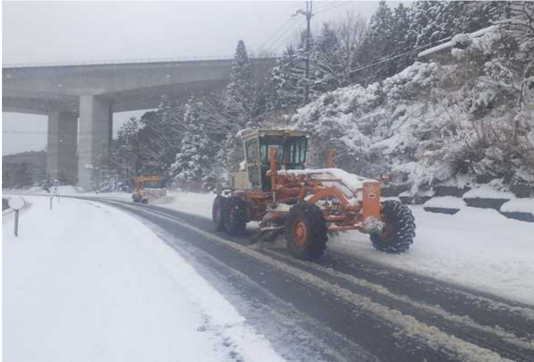
国道1号の除雪作業(甲賀市土山町地先・新名神高架下付近・下り)
