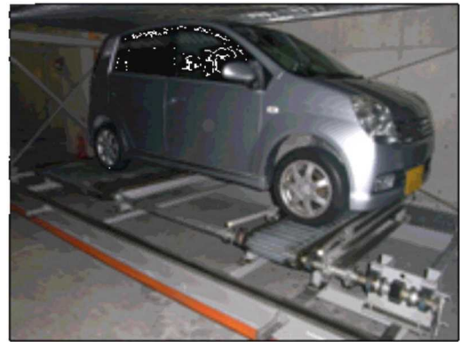
機械式駐車場設備の事例
