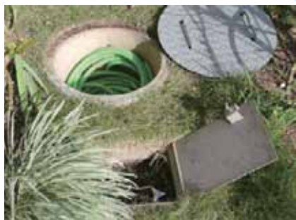
散水栓とホースの収納場所
