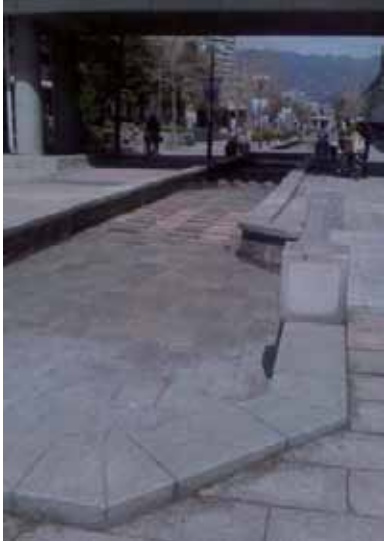
漏水のあった人工河川支流
