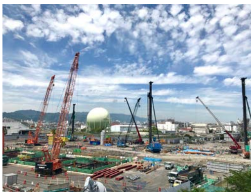
西部処理場 写真提供：神戸市
