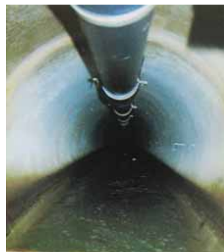
幹線管渠内に設置された送水管
