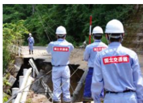
被災状況調査 【令和4年8月4日からの大雨】
