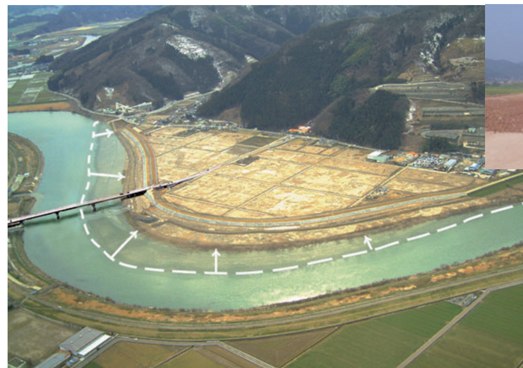
日野川：河床掘削(かしょうくさく)状況 点線部分の河床に堆積した土砂を除去し、洪水時の流量の確保を図ります
