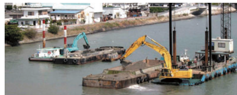
洲本川：河床掘削(かしょうくさく)状況 河床掘削により降雨時に低水位を確保し洪水防止を図ります
