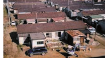
老朽化した公営住宅
