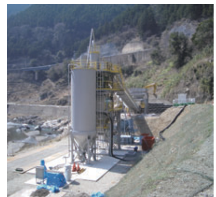
CSGプラント写真 (平成18年3月撮影)
