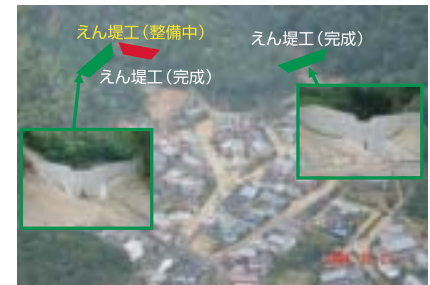
被災直後の全景(京都府宮津市滝馬地区)
