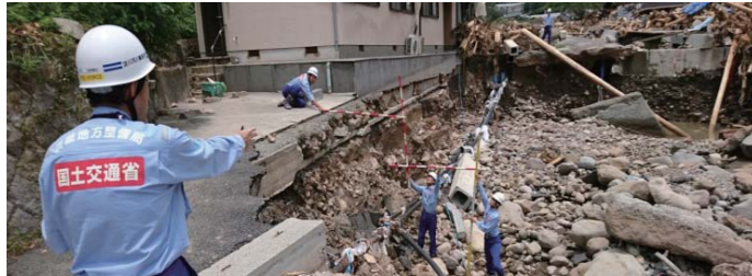
崩落した道路の被災状況調査を実施(平成29年九州北部豪雨)
