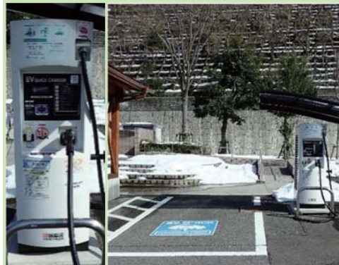
道の駅「河野」におけるEV充電器の設置状況
