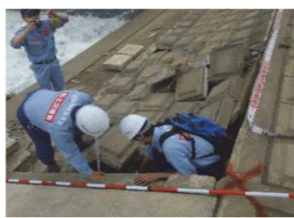
被災状況の調査 (平成27年9月関東東北豪雨:常総市)
