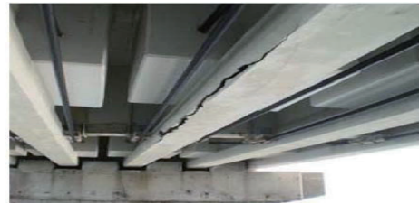
主桁のひび割れ（一般国道42号 古座大橋）
