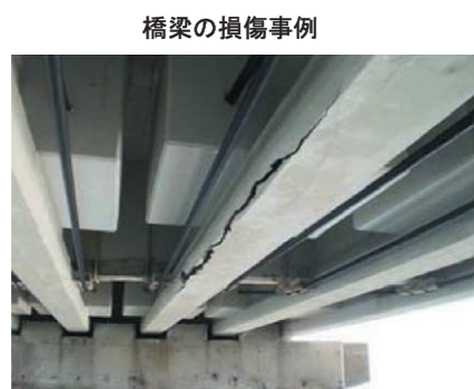
主桁のひび割れ（一般国道42号 古座大橋）
