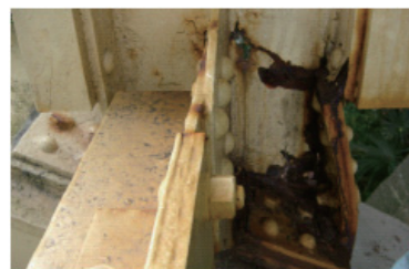
支柱の座屈（国道1号白川橋）
