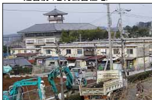
建替前(老朽公営住宅)
