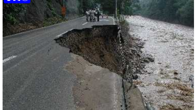
福井豪雨による増水で崩壊した国道158号 (福井市小和清水町付近)
