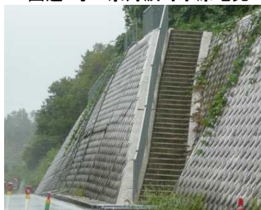
擁壁変状により 全面通行止め(H23.9)
