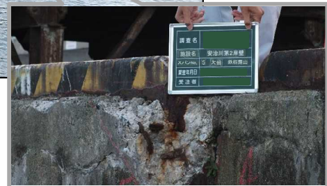
コンクリートの欠損、鉄筋露出
