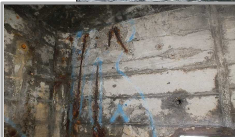
コンクリートの剥離、鉄筋露出
