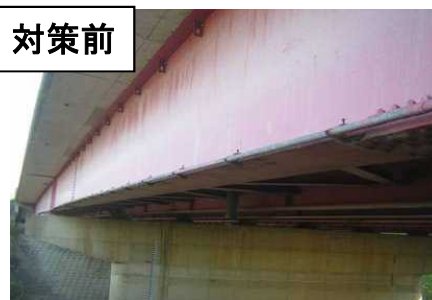
防食機能の劣化
