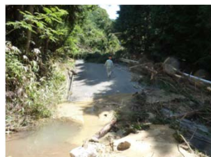
H25 台風18号による土砂流出
