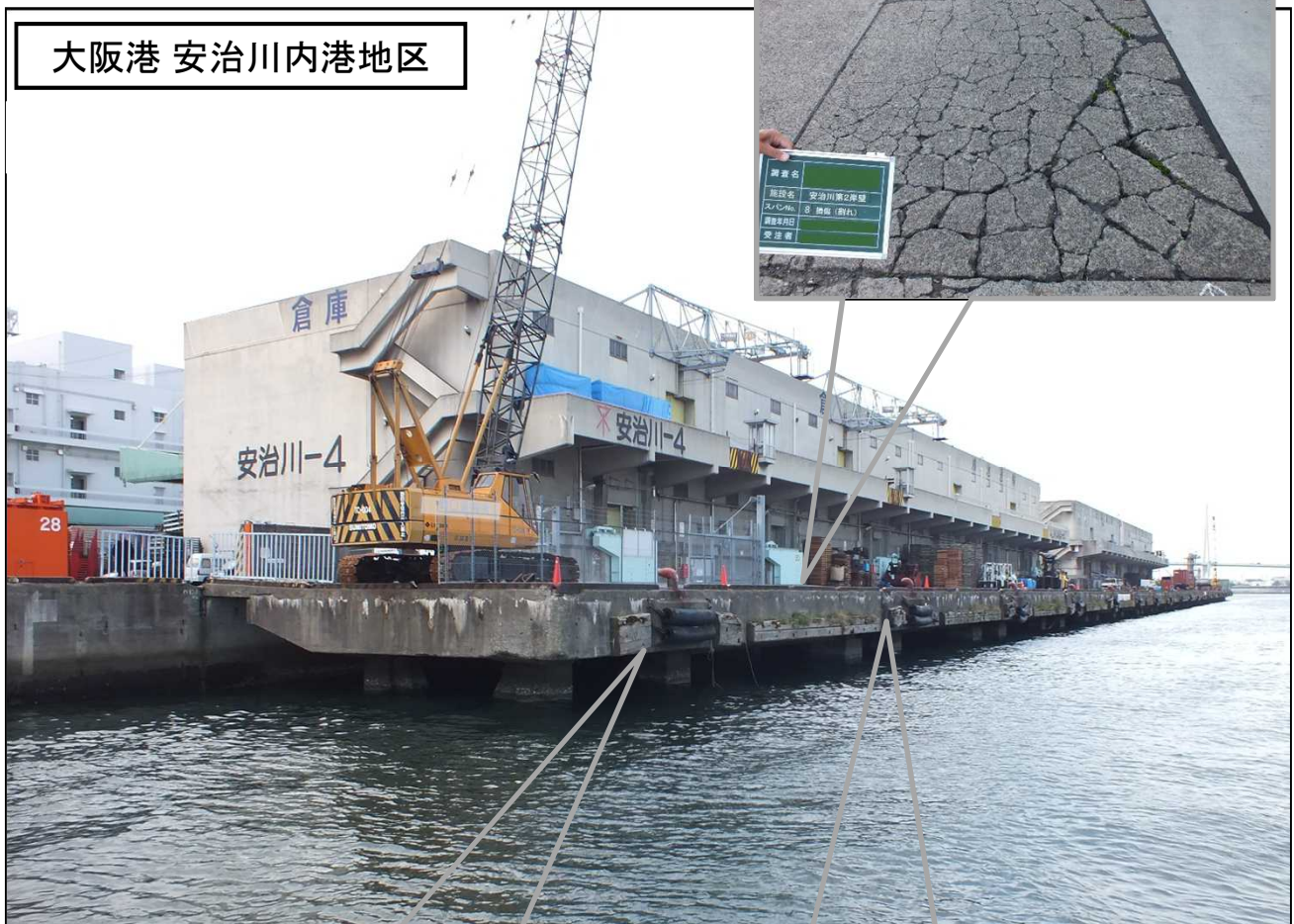
エプロン部のクラック
