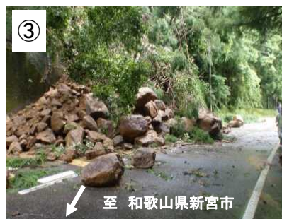
法面崩壊状況(H29)
