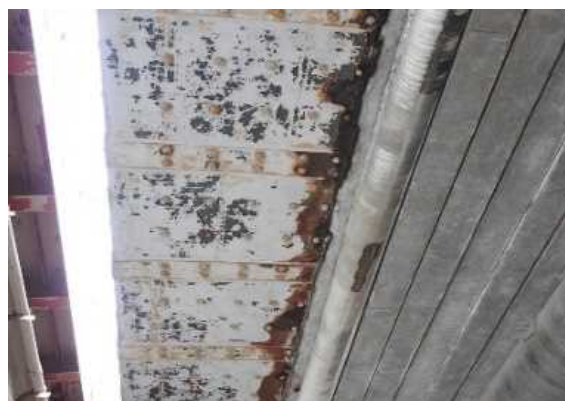
補強鋼板の腐食
