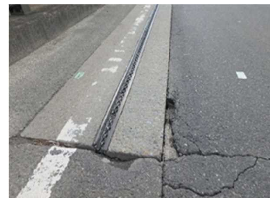
縦目地部の損傷
