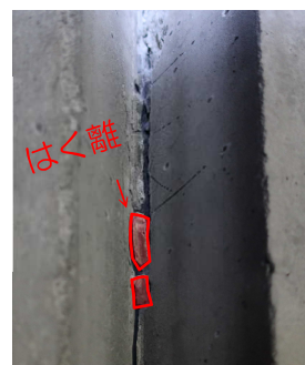
横断目地内のはく離
