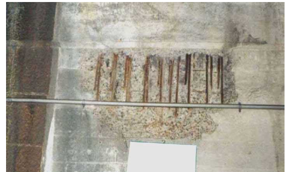
⑦剥離・鉄筋露出の例
