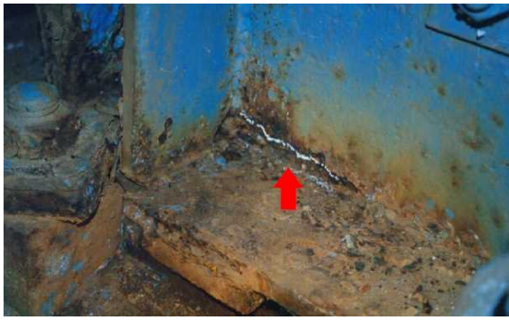
②亀裂の例
