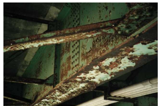
① 腐食の例
