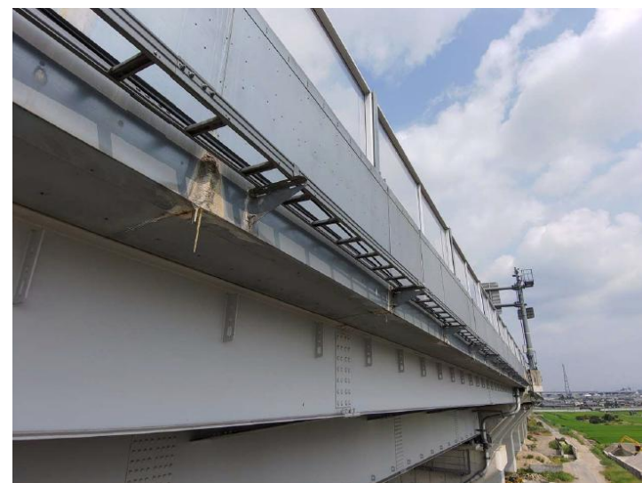
写真-4 防護柵(漏水・遊離石灰:d)
