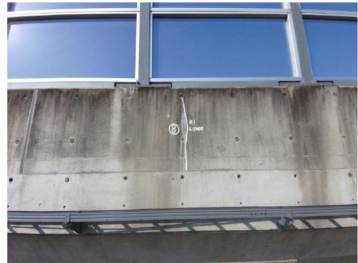
写真-4 防護柵 (ひびわれ W=0.1mm:b 漏水・遊離石灰:d)
