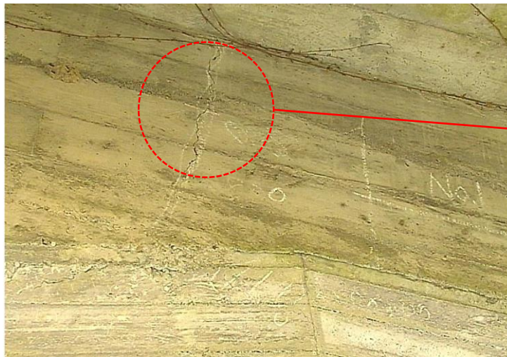
写真-3 損傷確認 (ひびわれ)
