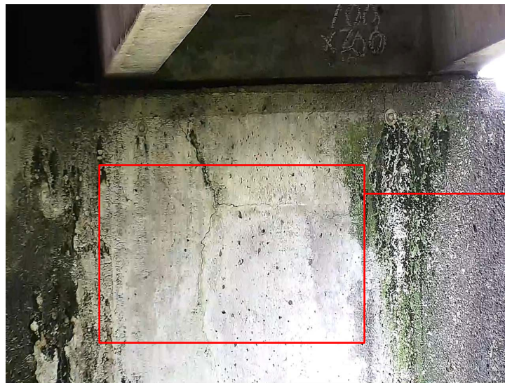
写真-3 損傷写真(ひびわれ)
