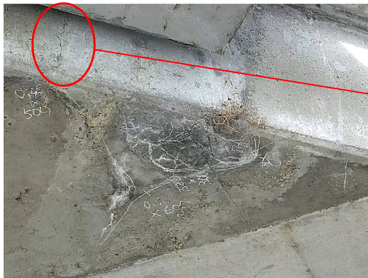
写真-3 主桁(ひびわれ W=0.9mm : e)
