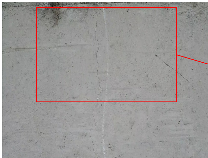
写真-3 損傷写真(ひびわれ)
