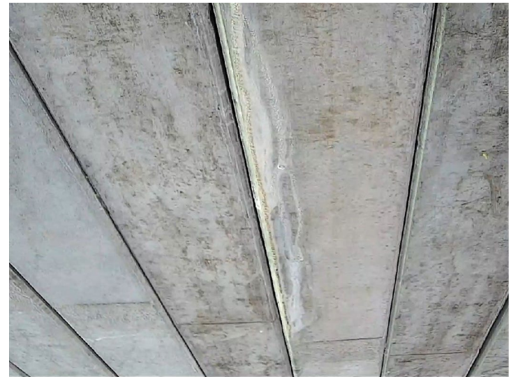
写真-2 床版(遊離石灰:d)
