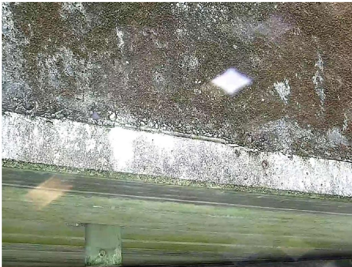
写真-3 地覆(鉄筋露出:d)
