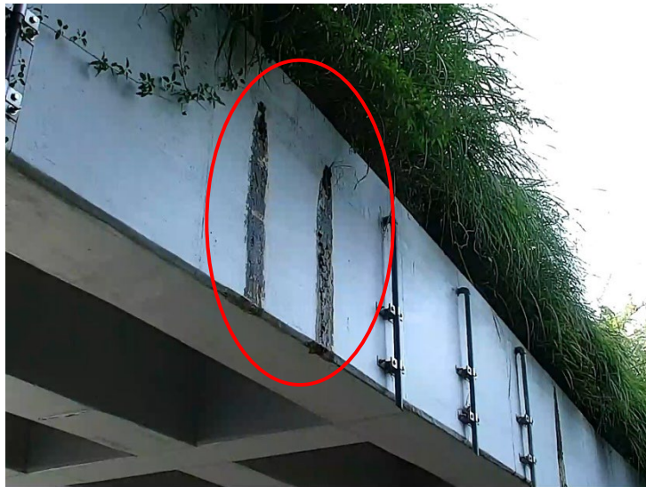
写真-3 主桁(漏水・滞水)
