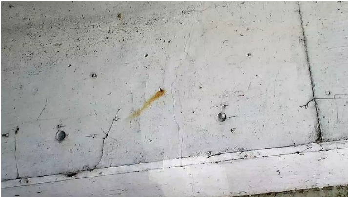
写真-3 落橋防止構造(ひびわれ w=0.3\text{mm} )
