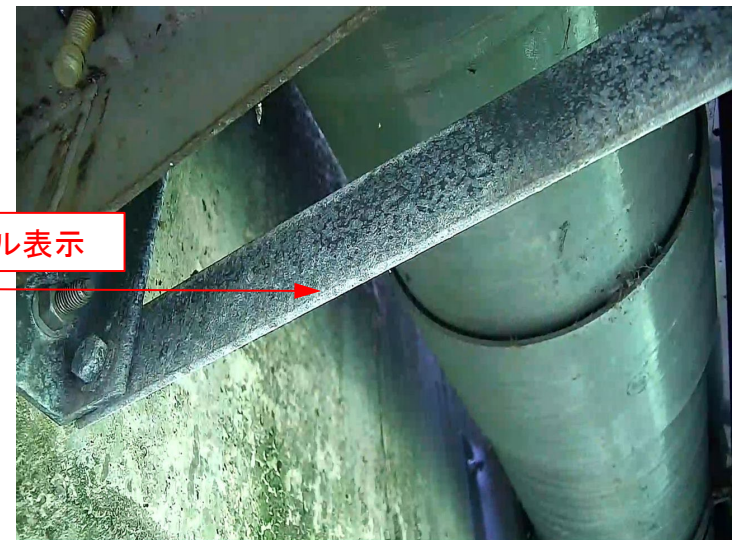
写真-4 損傷部拡大写真
