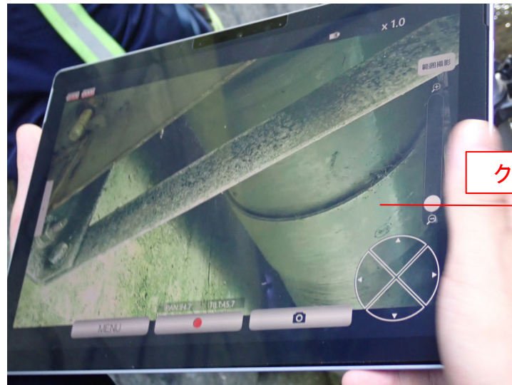
写真-3 損傷確認[ひびわれ]
