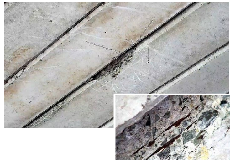
写真-4 主桁(剥離・鉄筋露出)
