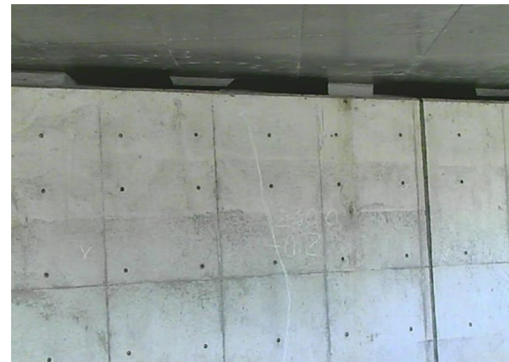
写真-4 縦壁(ひびわれ)
