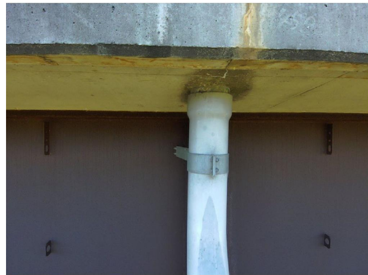
写真-4 排水管(漏水・滞水:e)
