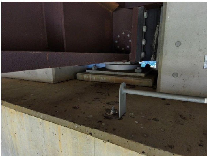
写真-3 沓座モルタル(ひびわれ)
