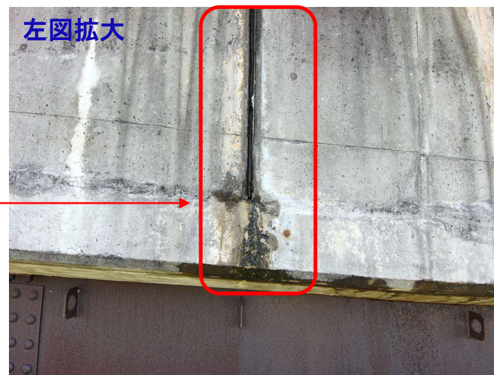
写真-4 地覆_漏水・遊離石灰
