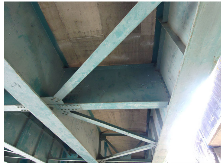
写真-4 横桁(防食機能の劣化:d)
