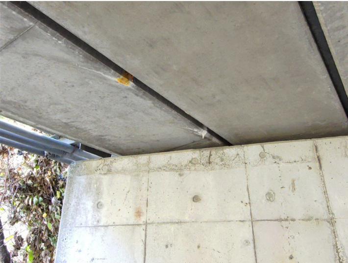
写真-3 床版(遊離石灰:d)
