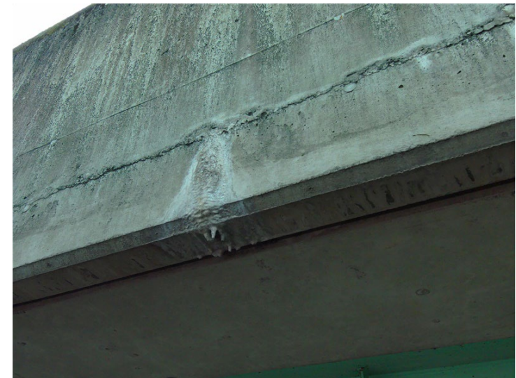
写真-4 地覆(遊離石灰:d)
