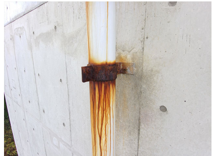
写真-4 排水管(腐食:b)
