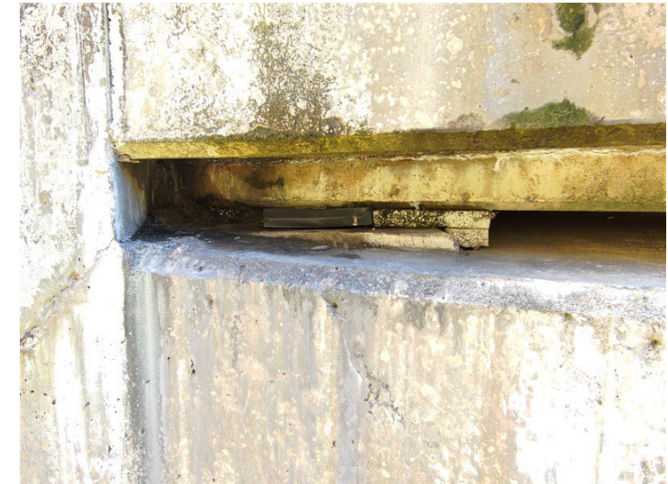
写真-4 支承(漏水・滞水:e)
