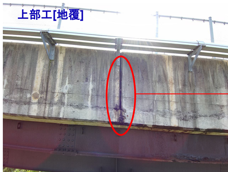
写真-3 損傷確認
