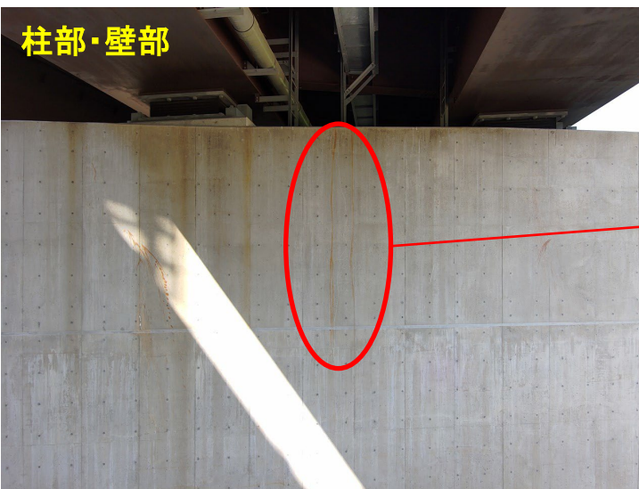
写真-3 損傷確認(ひびわれ)
