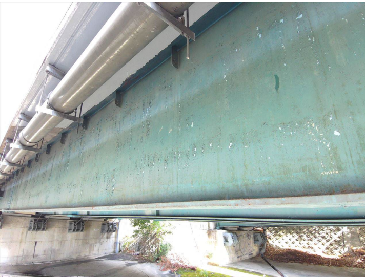
写真-3 主桁(防食機能の劣化:d)
