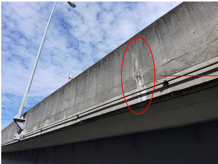
写真-3 損傷写真(ひびわれ)
