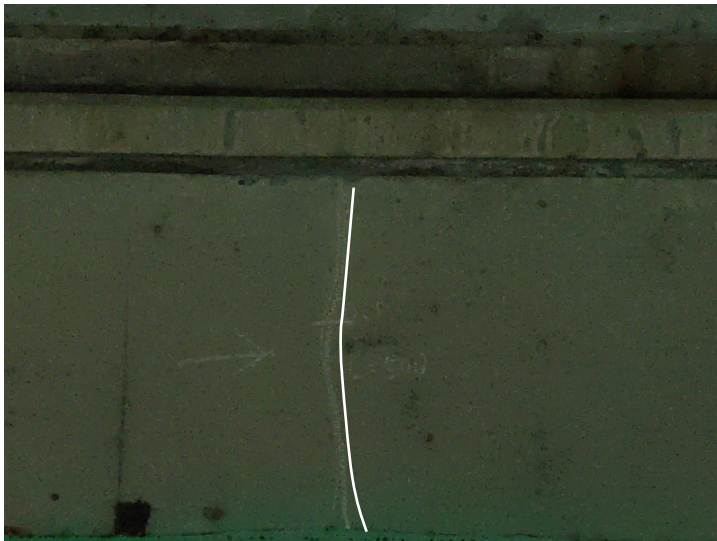
写真-3 床版ひびわれ(ひびわれ=0.1mm:c)
