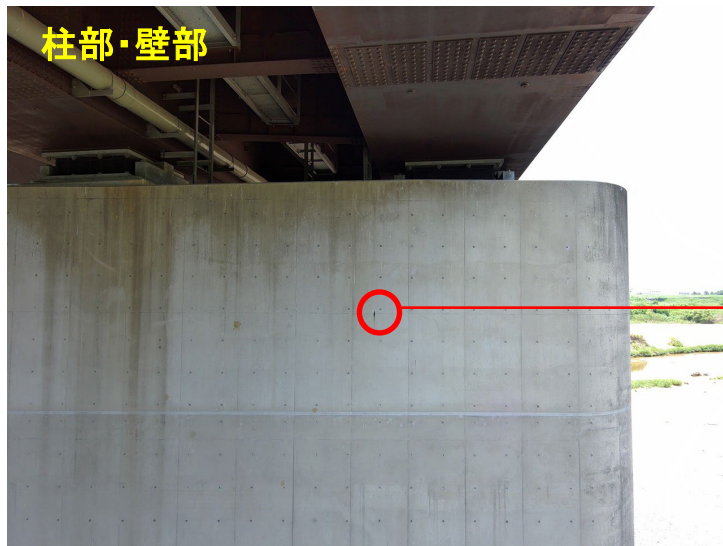
写真-3 損傷確認
