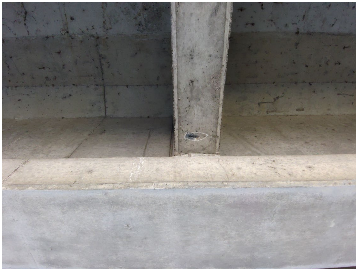
写真-3 横桁(剥離・鉄筋露出)
