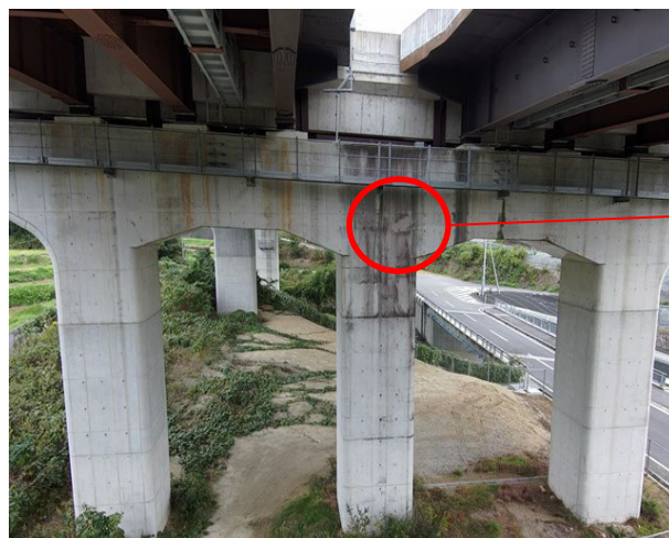
写真-3 伝い水汚れ、ひびわれ
