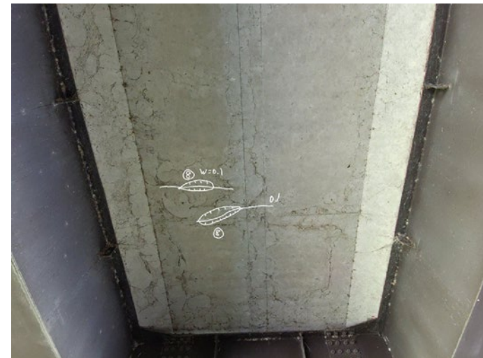
写真-4 床版(遊離石灰)
