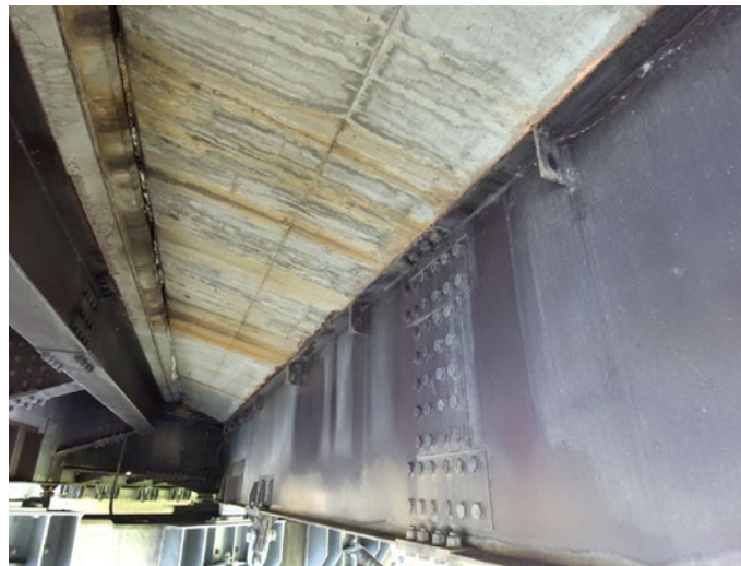
写真-3 主桁(腐食)
