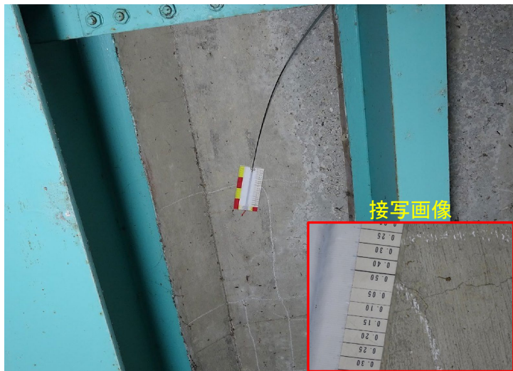
写真-3 床版（ひびわれ）
