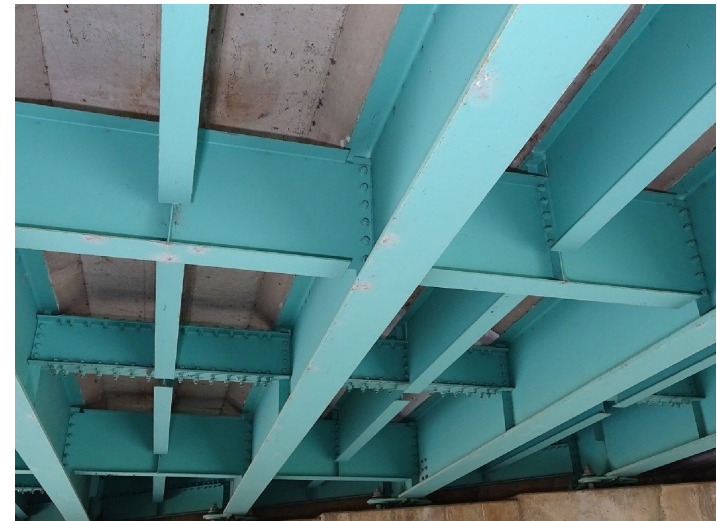
写真-4 主桁（腐食）
