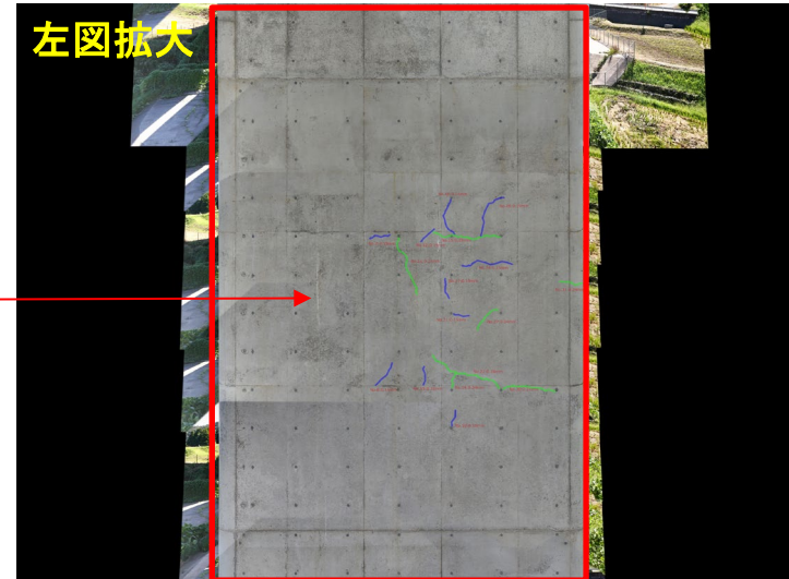
写真-4 損傷検出合成画像
