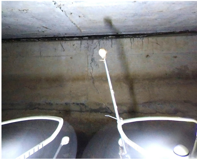
写真-3 縦壁(ひびわれ:d)
