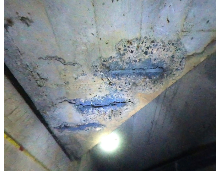
写真-2 主桁(鉄筋露出:e)
