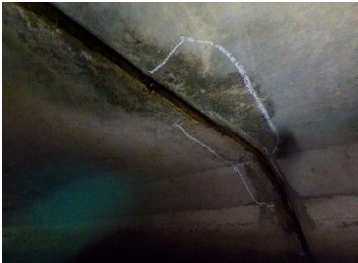
写真-3 頂版(遊離石灰)
