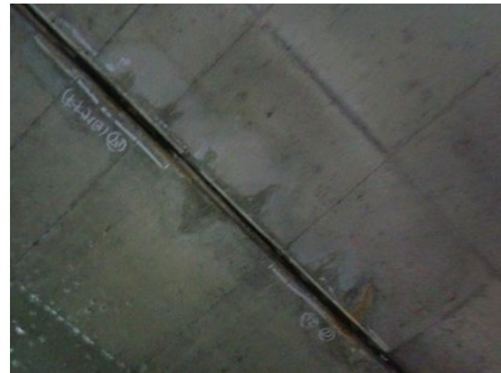
写真-4 目地部(漏水)
