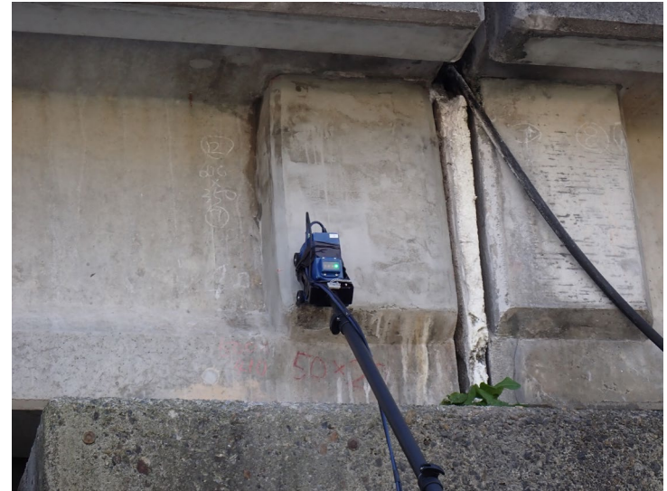
写真-2 健全判定(LED緑)
